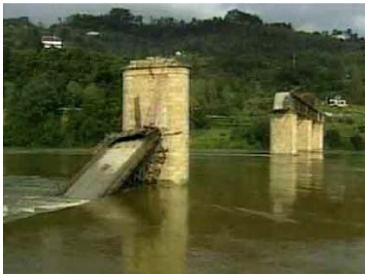
Figura 2 – Ponte Entre-os-Rios (Portugal-2001)
