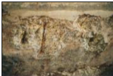
Fig. 3.5 – Patologia originada pela reacção sulfática (Brouxel 2009).
