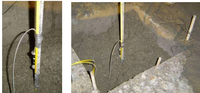
Fig. 2.44 – Exemplo da aplicação de sensores de deformação embebidos em betão (FiberSensing)
