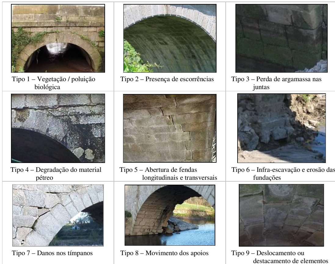
Fig. 3.23 – Exemplos de patologias em Obras de Arte de alvenaria de pedra (EP 2007)
