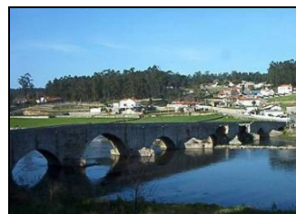
Fig. 5.44 – Estado da pontes após colapso de 2004
