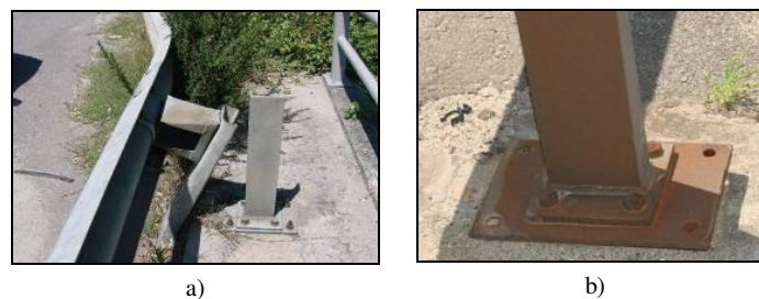
Fig. 3.38 – Exemplos de patologias nas guardas de segurança: a) Dano devido a um embate de um veículo; b) Corrosão das chapas de fixação e ausência de elementos de ligação.
