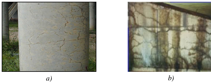
Fig. 3.4 – Patologia originada pela reacção álcalis-sílica: a) pilar de betão armado (Silva 2996); b) encontro de uma Passagem Superior (Brouxel 2009).
