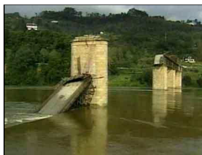
Fig. 2.1 – Colapso da Ponte Hintze Ribeiro
