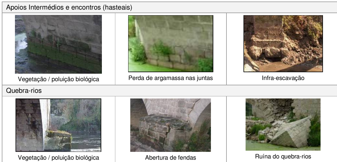
Fig. 5.45 – Principais patologias da Obra de Arte por elemento estrutural
