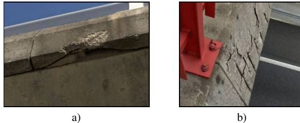
Fig. 3.42 – Exemplos de patologias nas cornijas: a) Delaminação pontual do betão originado por um embate /colisão; b) Descasque do betão de recobrimento
