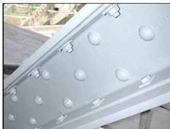
Fig. 4.17 – Reforço de elementos com chapas, Ponte Metálica de Vila Real sobre o Rio Corgo, (EP 2003).
