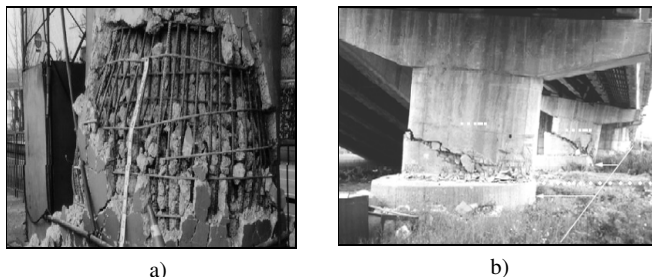
Fig. 3.45– Exemplos de danos em pilares devido à acção sísmica Kobe 1995: a) falta de confinamento lateral; b) dano num pilar curto (Kawashima 2009).
