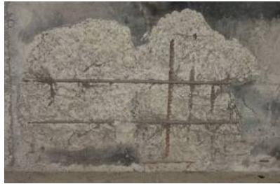
Fig. 3.3 – Patologia originada pela acção do fogo
