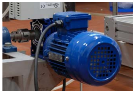
Figura 4.14 – Vista do grupo motor-redutor.
