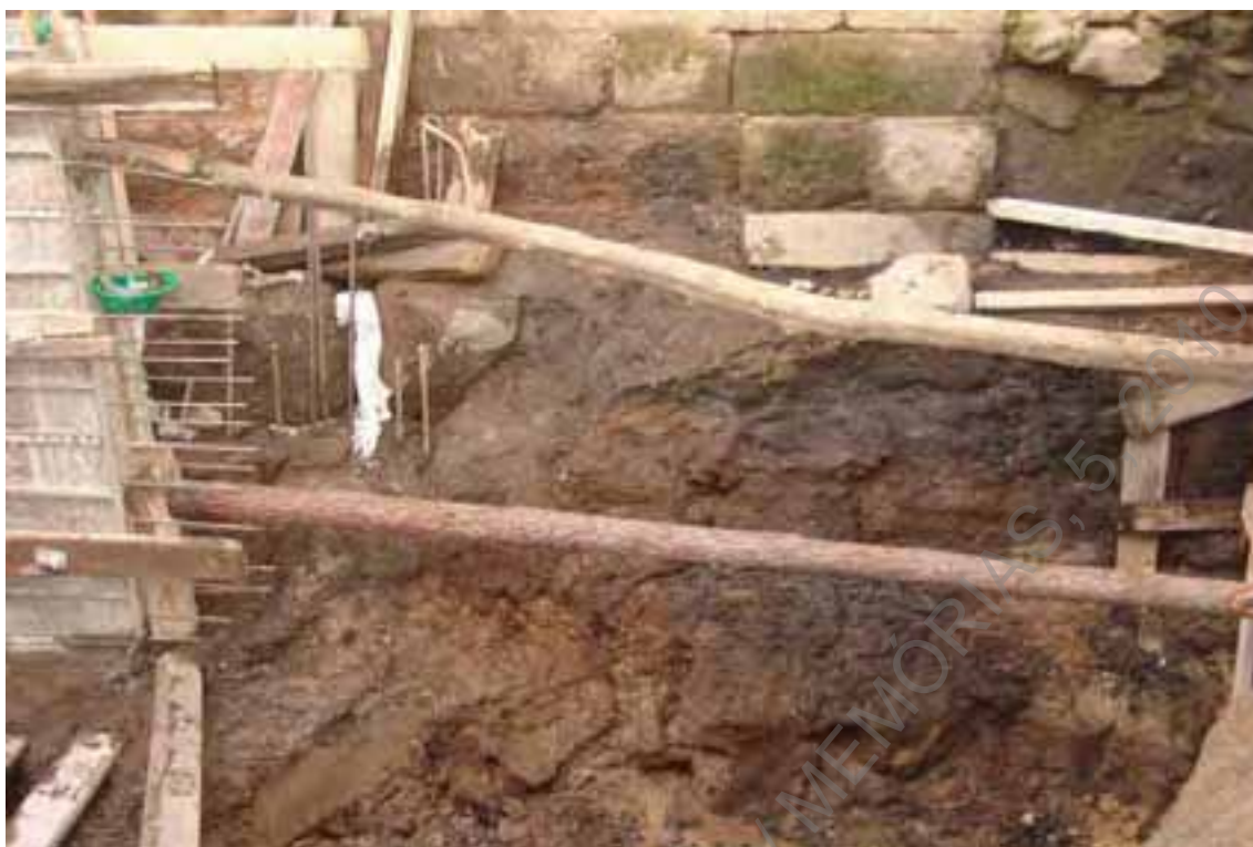
Foto 117 (D379) Aspecto parcial após desabamento do testemunho .
