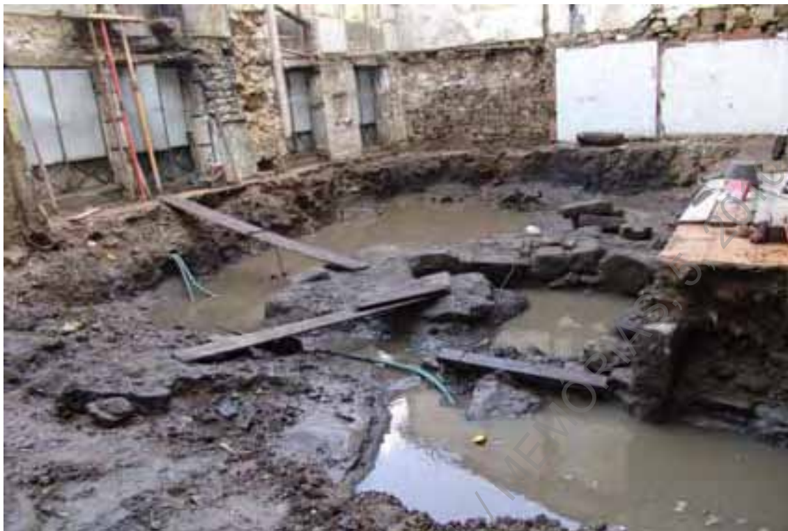
Foto 1 (D 171) Acompanhamento – aspecto geral da área escavação após desaterro inicial, orientação S/N
