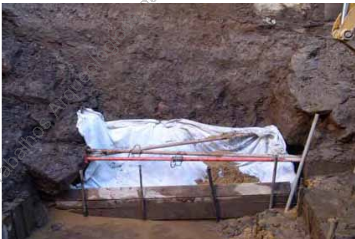
Foto 116 (D 373) Cobertura com geo-têxtil da estrutura exposta após o desabamento do testemunho.
