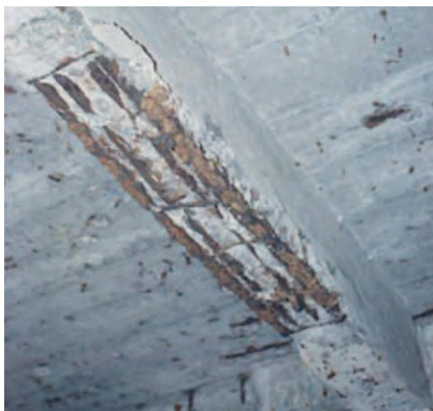
Figura 2 – Destacamento da camada de recobrimento em viga de betão devido à formação de produtos de corrosão
