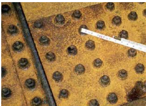
Início de corrosão em aço normal – cor amarela alaranjada
