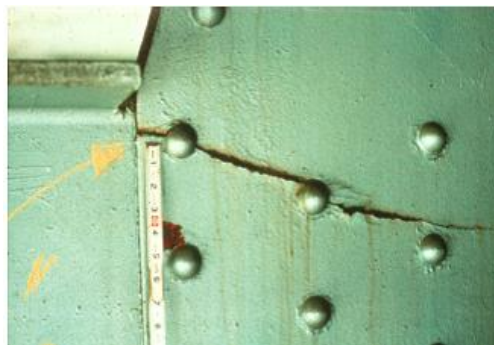
Figura A.3-5 – Fissura numa ligação rebitada (Bridge Inspector's Reference Manual, 2006)
