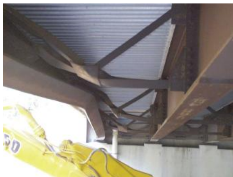
Figura A.3-7 - Impacto de veículo no tabuleiro (Bridge Inspector's Reference Manual, 2006)
