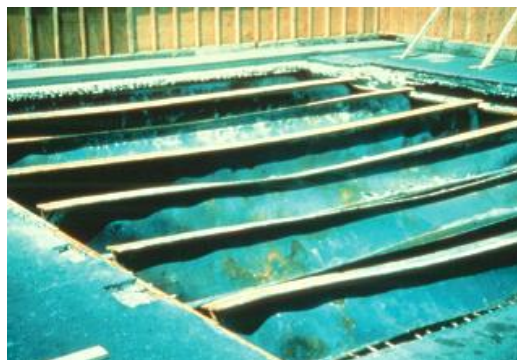
Figura A.3-8 - Distorção por exposição a fogo (Bridge Inspector's Reference Manual, 2006)
