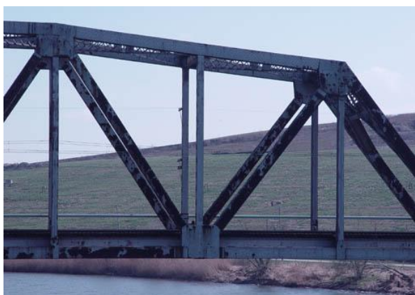
Figura A.3-1 - Corrosão numa ponte metálica em treliça (Bridge Inspector's Reference Manual, 2006)
