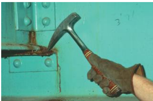
Figura A.5-1 – Ferrugem entre chapas (Bridge Inspector's Reference Manual, 2006)
