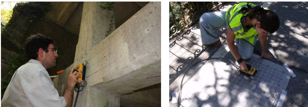
Figura 4. Perfil georadar linear no nó da estrutura e mapeamento tridimensional no pavimento.
