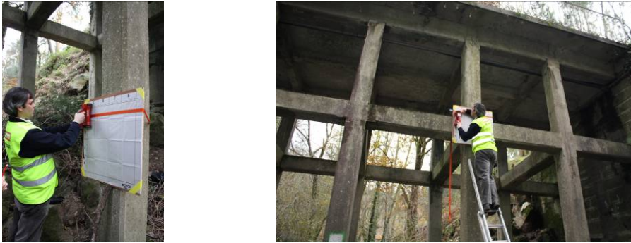
Figura 3. Mapeamento dum pilar (lado transversal) e dum nó através do detector de armaduras.
