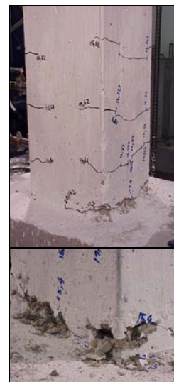
Figura 13: Danos na zona da rótula plástica
