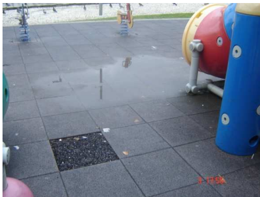
Fotografia nº 12- Pavimento do parque danificado
