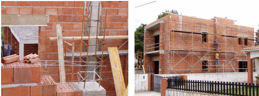
Figura 16 : Alvenaria moderna confinada com blocos cerâmicos de furação vertical: residência em Ílhavo. Fotografias gentilmente cedidas por F. Pagaimo.
