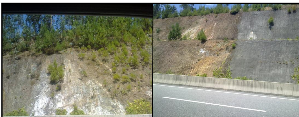
Figura 1.4 – Manifestações de drenagem ácida, resultantes da evolução de rochas sulfuretadas num talude de estrada (A27 troço Viana do Castelo e Ponte de Lima).
