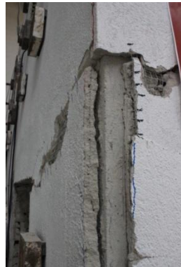
(c) Destacamento de reboco no canto Noroeste
