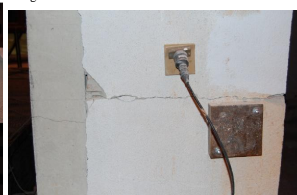
(e) Fenda por esforço de corte a meia altura do pilar Noroeste
