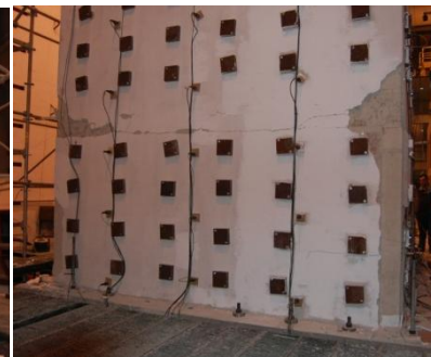
(c) Destacamento do reboco nas faces de vigas e pilares, essencialmente nos cantos
