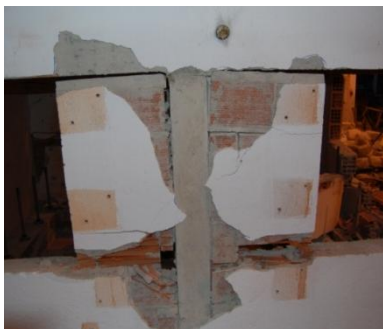
(a) Alvenaria segura apenas pela armadura de junta e conectores metálicos
