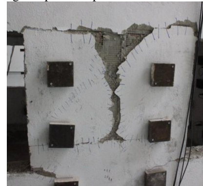
(d) Dano na ombreira da fachada Oeste
