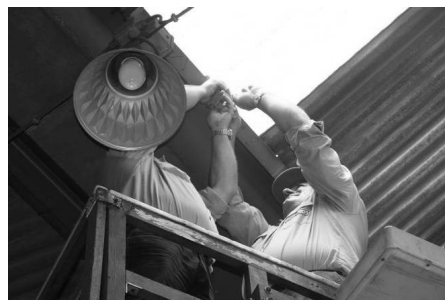
Figura 6 – Dispositivos de iluminação artificial existentes (vapor mercúrio)
