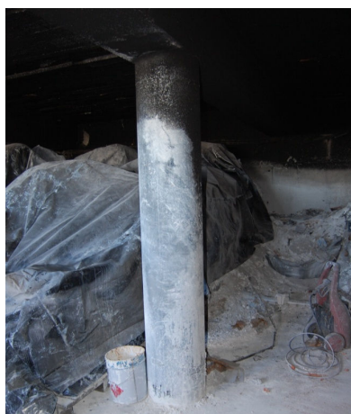
Figura 6.27 – Pilar com betão de recobrimento não afetado (com base em inspeção visual)
