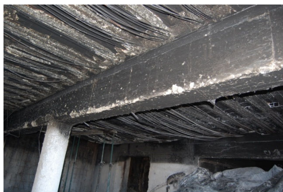
Figura 6.30 – Vigas com pontuais ocorrências de destacamento (a amarelo na Figura 6.33)
