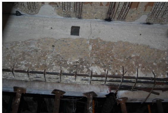
Figura 6.32 – Fendas em elementos estruturais (de origem térmica) – designadas por “N” na Figura 6.33
