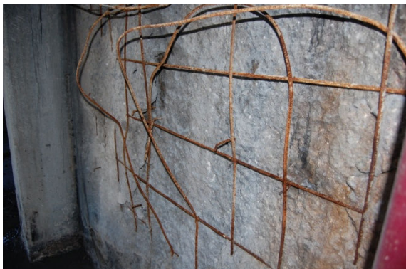
Figura 6.25 – Destacamento significativo (cerca de 10 cm) e consequente exposição direta das armaduras ao fogo
