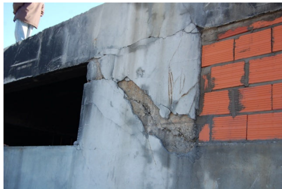
Figura 6.26 – Danos na ligação entre pilar embebido em muro de suporte e viga existente ao nível da laje
