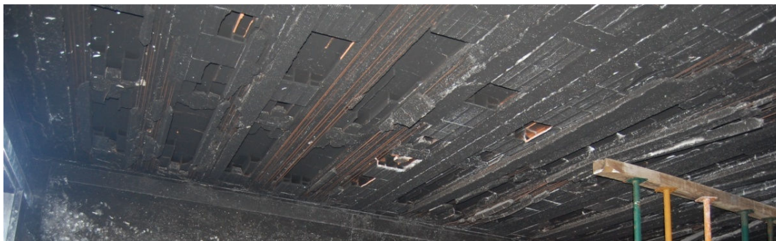
Figura 6.23 – Vigotas pré-esforçadas e abobadilhas destruídas – V+A
