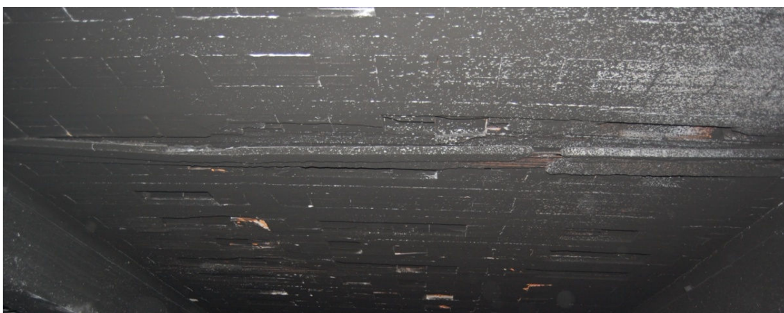
Figura 6.22 – Vigotas pré-esforçadas sem dano aparente mas abobadilhas destruídas - A
