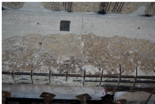
Figura 6.71 – Macro-fenda a meio vão do tramo intermédio (Tramo 1 do Pórtico 3)
