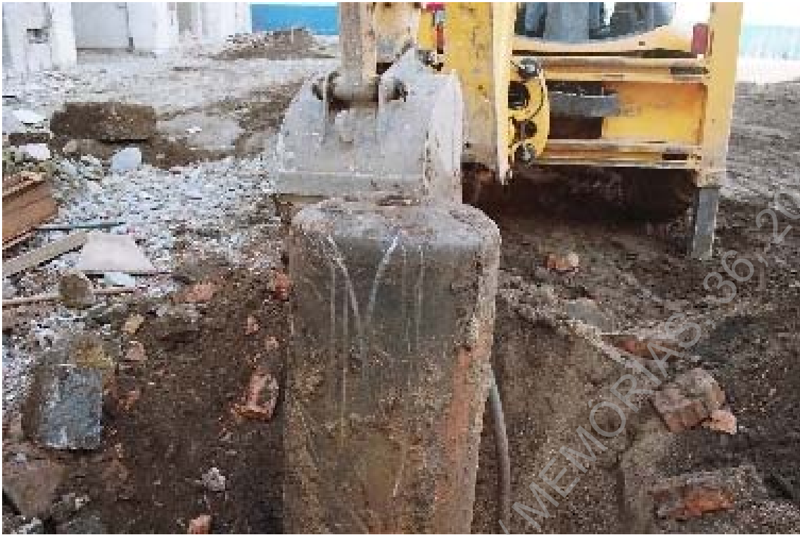
Foto 13 – Desaterro do macaco hidráulico (UE177), sendo visíveis os elementos de tijolo que forravam o equipamento.
