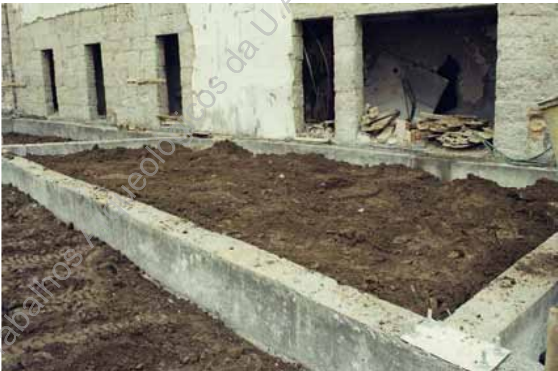
Foto 19 – Perspectiva do sector oeste do terreno com a infra-estrutura de suporte para pavimento.
