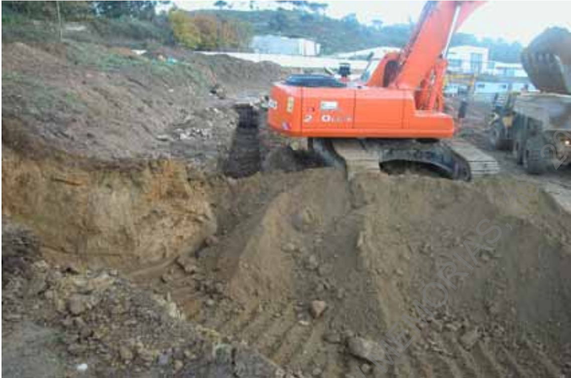
Foto 15- Destruição da canalização, panorâmica Sul – Norte.
