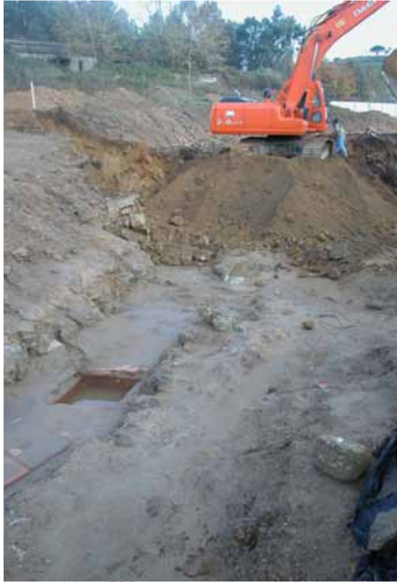
Foto 14- Destruição causada pela máquina retro-escavadora durante o fim-de-semana.
