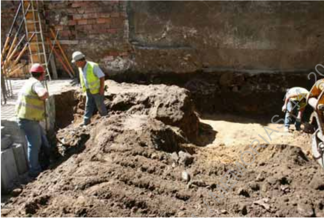
Foto 32: (UAUM – IMG_8001) Abertura de vala – (N/S).
