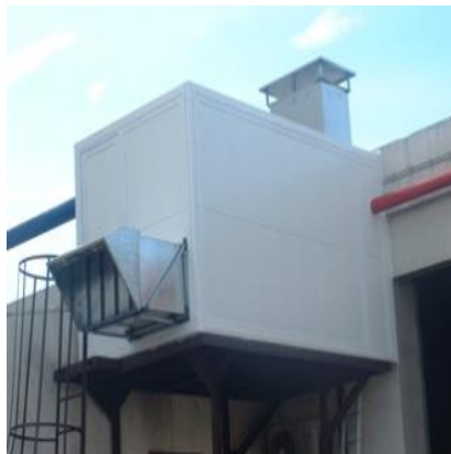
Figura 2.2 – Encapsulamento de um gerador de uma fábrica [5].
