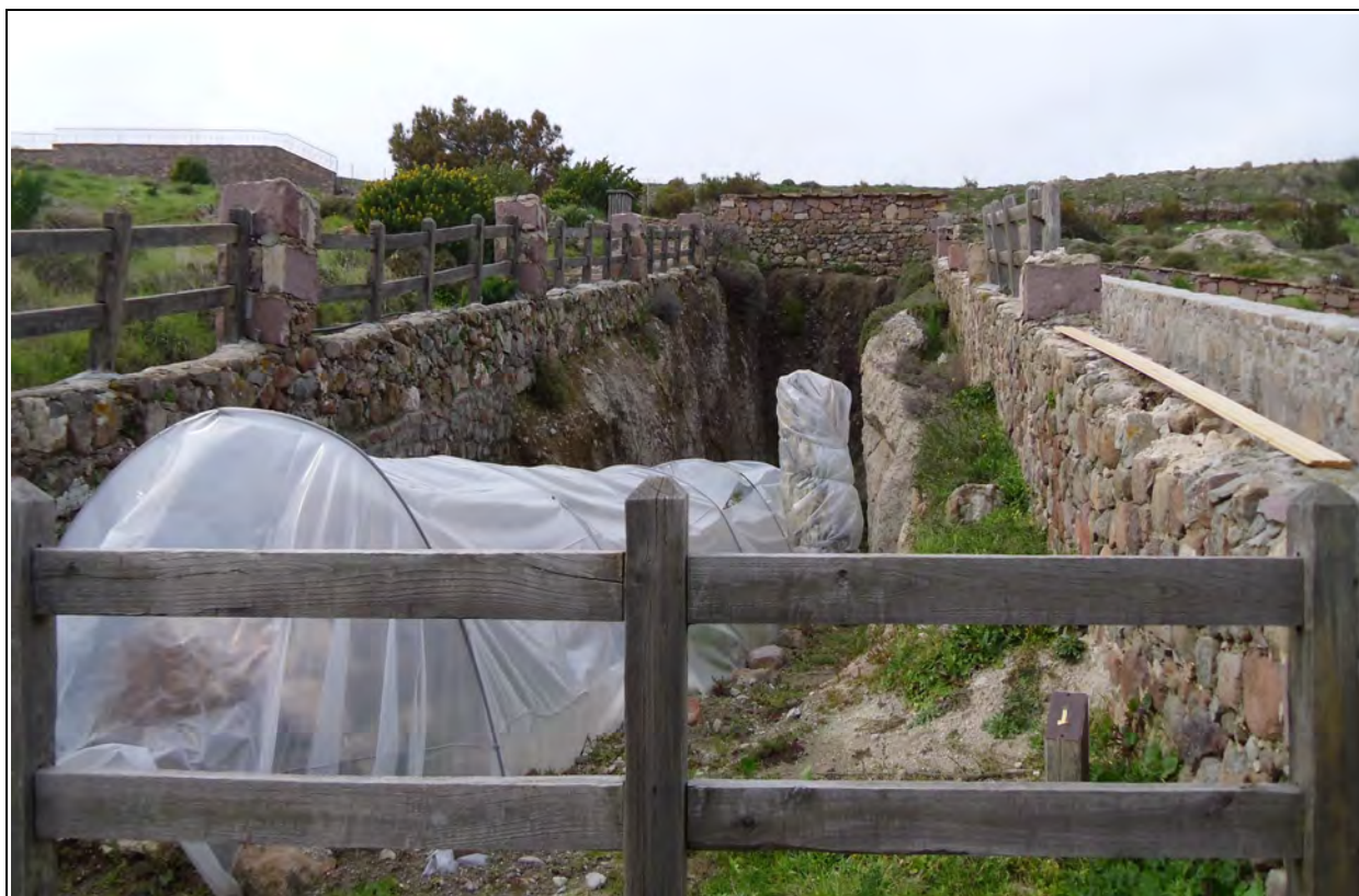
Figura 6.1 – Pormenor dos trabalhos de conservação – cobertura plástica temporária e alargamento do muro de contenção (à direita) - implementados no geossítio n.º1 – do trilho 1 (no P.F.P.) - observado a 4 de Março 2011.
