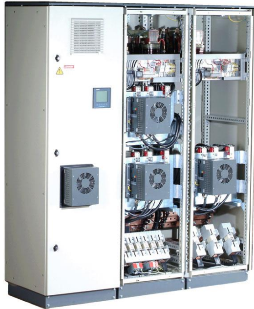
Figura 3. 7 – Quadro eléctrico típico de baterias de condensadores; el/spec [13].
