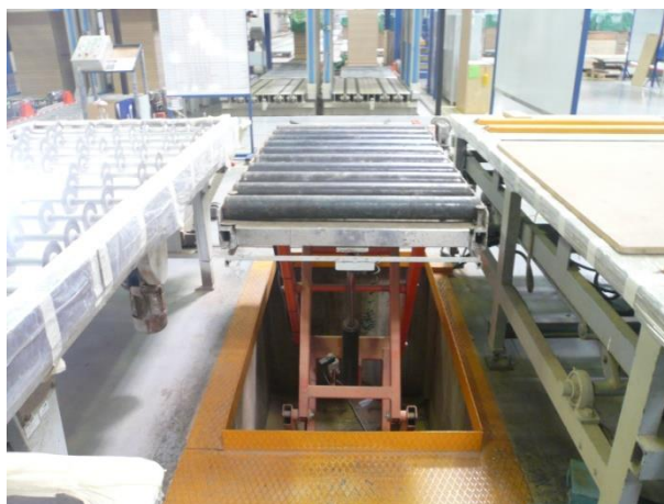
Figura 61 – Elevador de Montagem BOF
