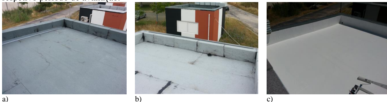
Fig. 4- Aspeto geral das coberturas e das diferentes soluções avaliadas: a) Solução XN em C6; b) Solução XB em C5; c) Solução XN/PB em C6
