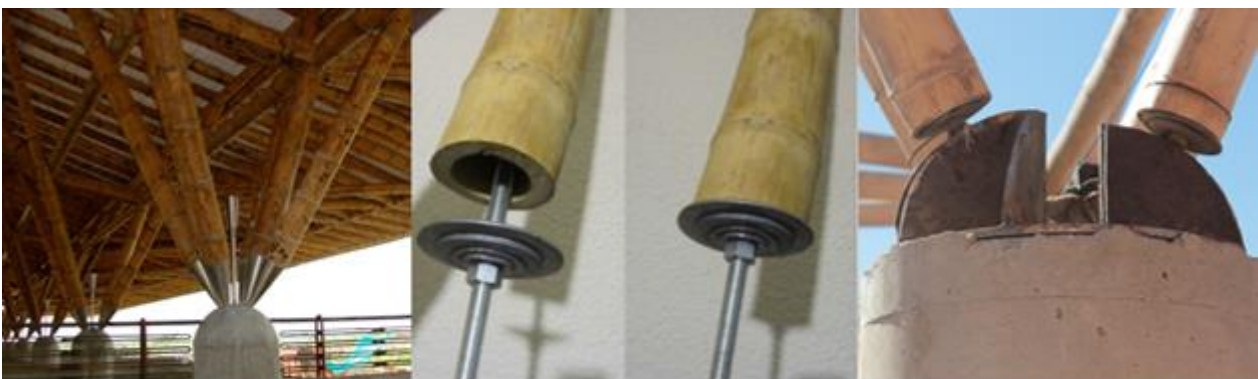
12. Conexão Simon Velez 13. Prototipo de conexão 14. Aplicação em obra, Sport city Oaxaca [autor]
