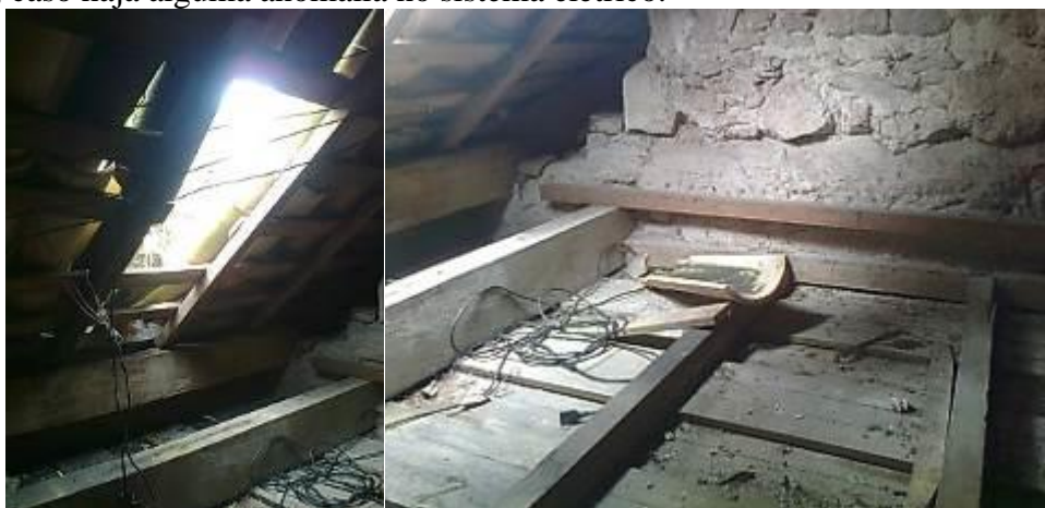
Figura 12 – Fios de eletricidade repousando sobre o madeiramento do forro.
