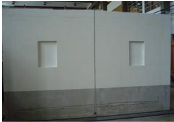
Figura 35: Aspeto de um dos sistemas analisados após ciclos higrotérmicos
