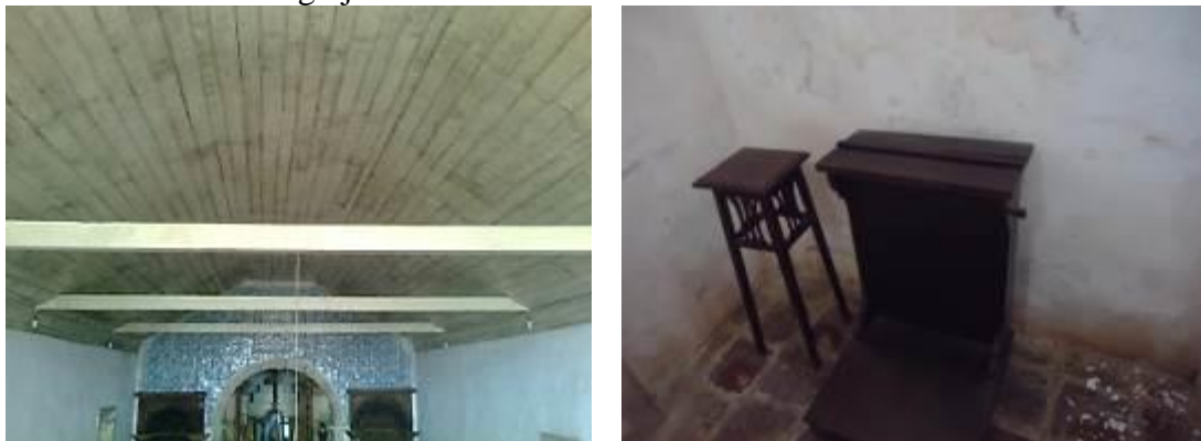
Figura 6 – Marcas generalizadas de umidade no forro (esquerda) e de umidade no piso e paredes (direita) da Igreja
