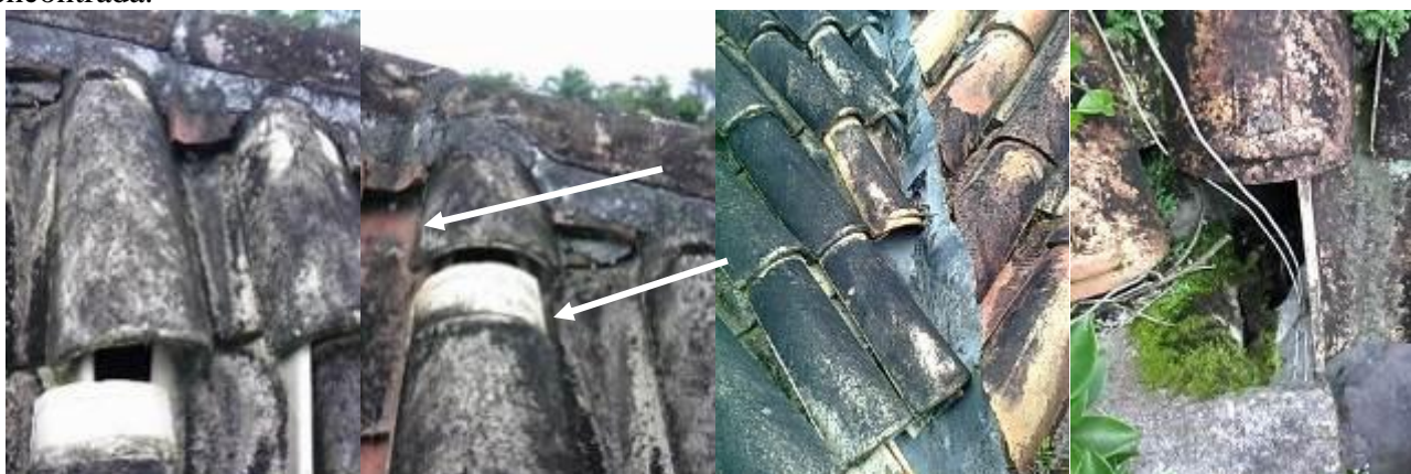
Figura 7 – Detalhe das telhas destacadas na cumeeira, com dois tipos de telhas cerâmicas (vermelha e branca)
