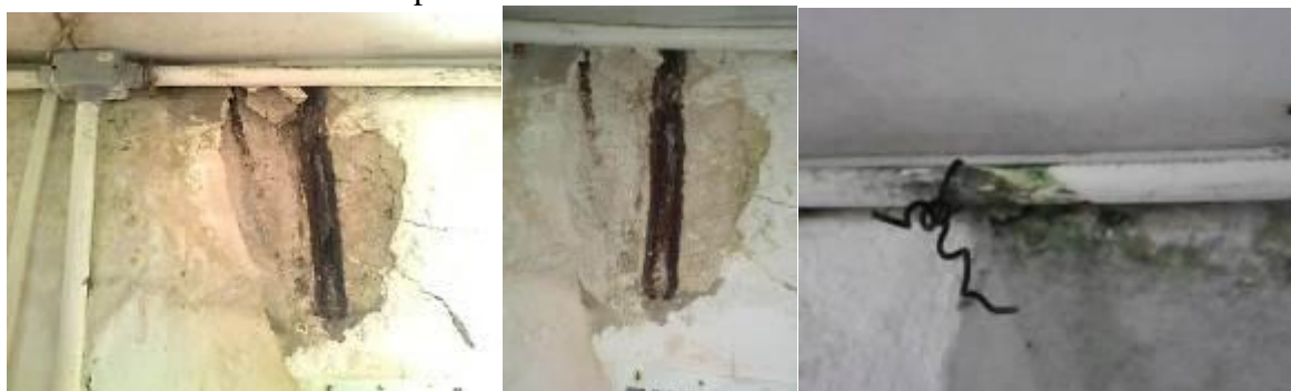
Figura 11 – Vista das manchas de infiltração em parede do Convento
