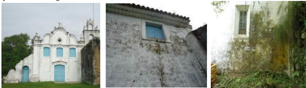
Figura 4 – Fachada e paredes laterais da Igreja com sinais de deterioração no revestimento.
