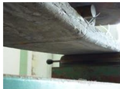
Figura 20: Fissuração e deformação da placa com adição de fibra de PET antes da ruptura
