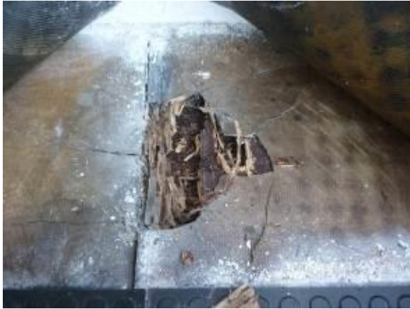
Figura 4: Apodrecimento interno do painel
