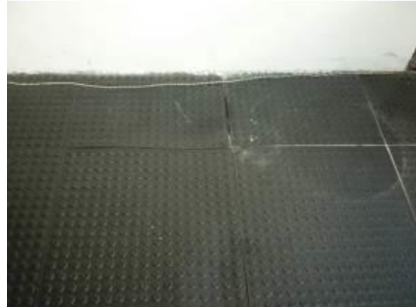
Figura 5: Piso com abaulamento
