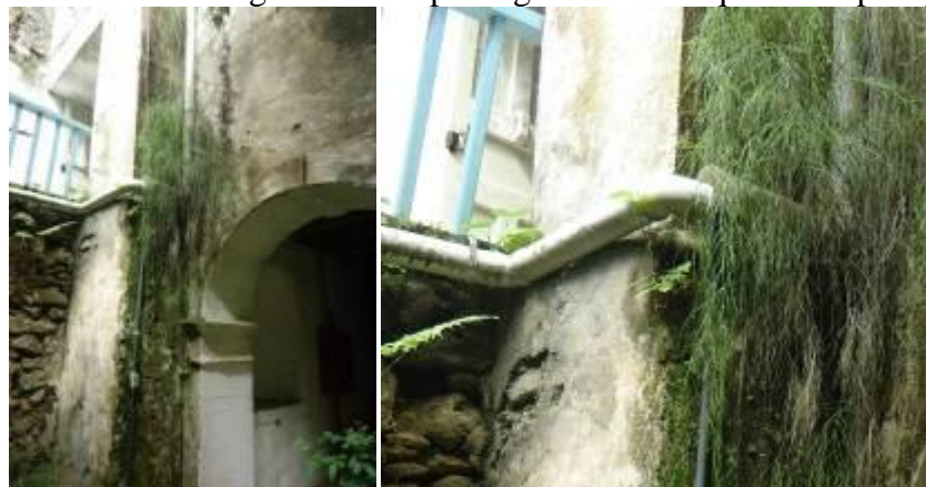
Figura 10 – Tubulação de águas pluviais desconectadas.
