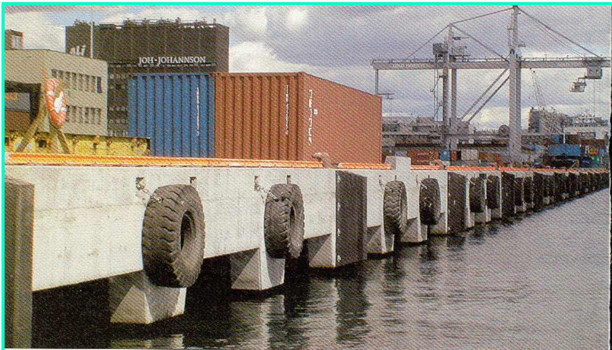
Fig. 11. "Nye Filipstadkaia" i Oslo (2001) fikk en høy saltinntrengning i betongen allerede under byggeperioden.
