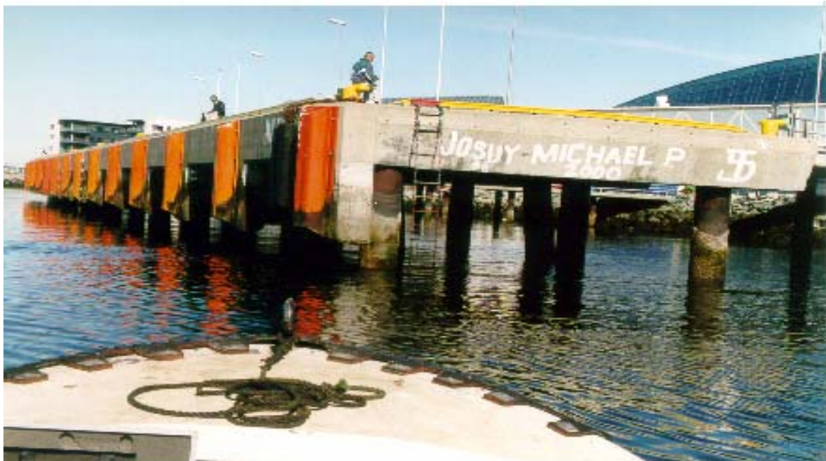
Fig. 1. "Turistskipskaia" (1993) i Trondheim fikk saltinntrengning og armeringskorrosjon etter en driftsperiode på ca. 8 år.
