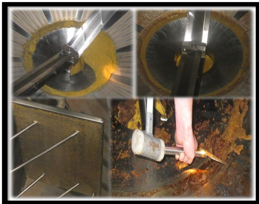
Figura 20 - Estado inicial da caldeira caldas.
