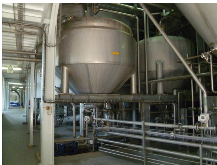
Figura 31- Pião (tanque de armazenamento do trub).
