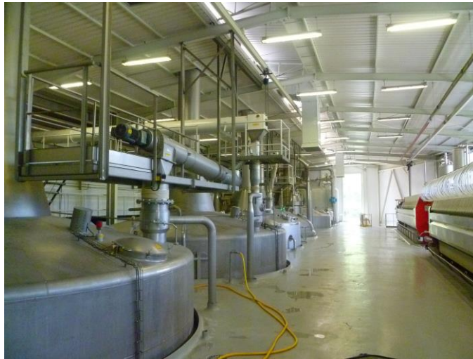
Figura 18- Sala de Fabrico Nordon .
