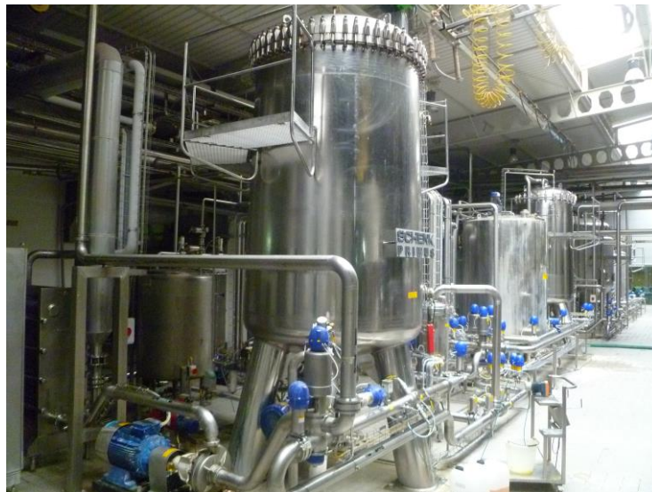
Figura 21- Linhas de Filtração 1 e 2, respetivamente.
