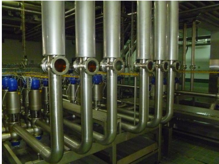
Figura 33- Tubagem dos TCFs.
