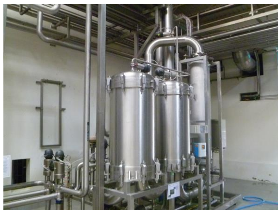
Figura 20- Instalação do Filtro de Levedura.
