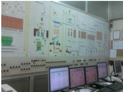
Figura 12 – Sala de comando da empresa. A sala de comando destina-se ao controlo de toda a produção, desde a entrada de matérias-primas nos silos até à saída do produto acabado, seja em sacos, seja a granel.
