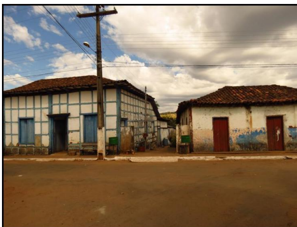
Figura 2: Casas na Rua da Cadeia em Pilar de Goiás - mal estado de conservação. Foto: L. N. M. Lima, 17 de julho de 2013.
