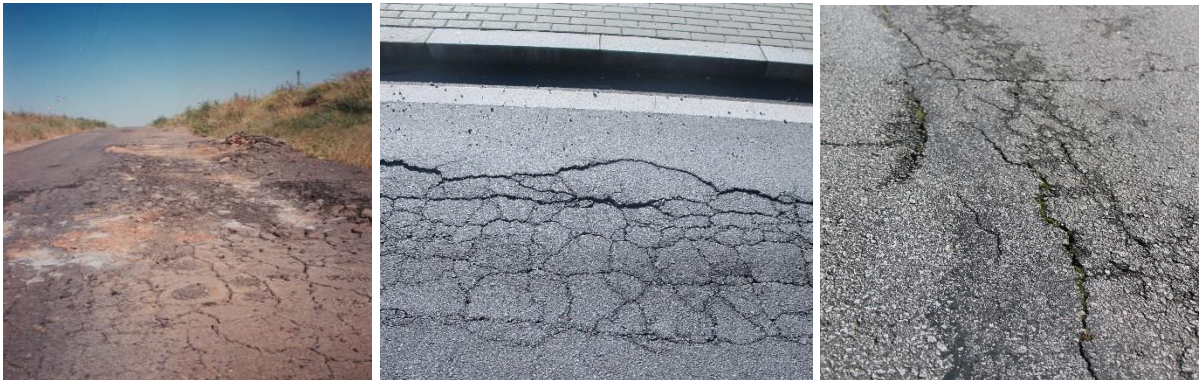
Figura 2.3 – Degradações dos pavimentos flexíveis
