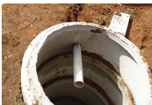
Figura 5- tubulação de saída para sarjeta
