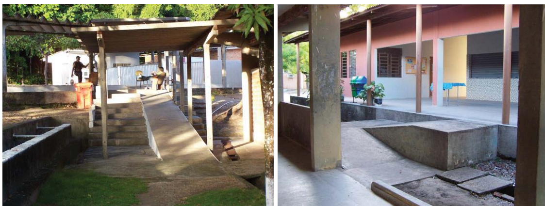
Fig. 3 e 4 Rampas fora de norma e sem proteção lateral encontradas no Campus I - UFPB.
