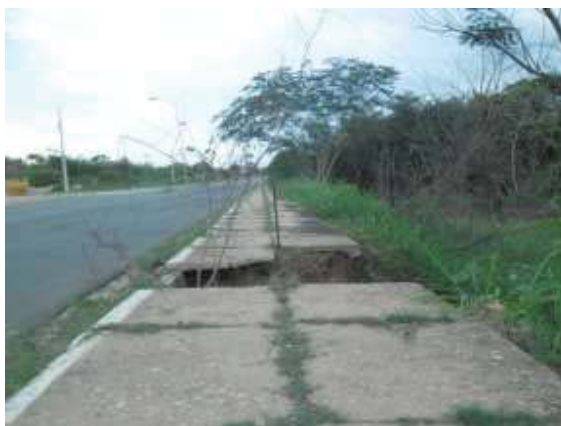
Fig. 2 - Erosões no passeio próximo ao setor de esportes.
