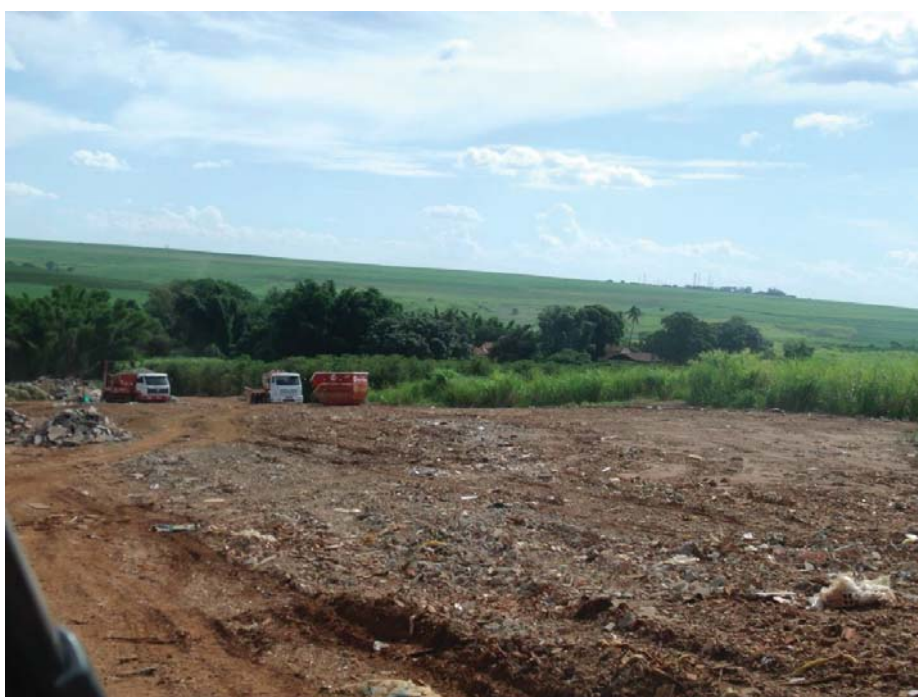
Figura 4. Detalhe da movimentação de cargas de RCC na nova área autorizada pela Prefeitura Municipal de Jaú Fonte: Autor (2014)
