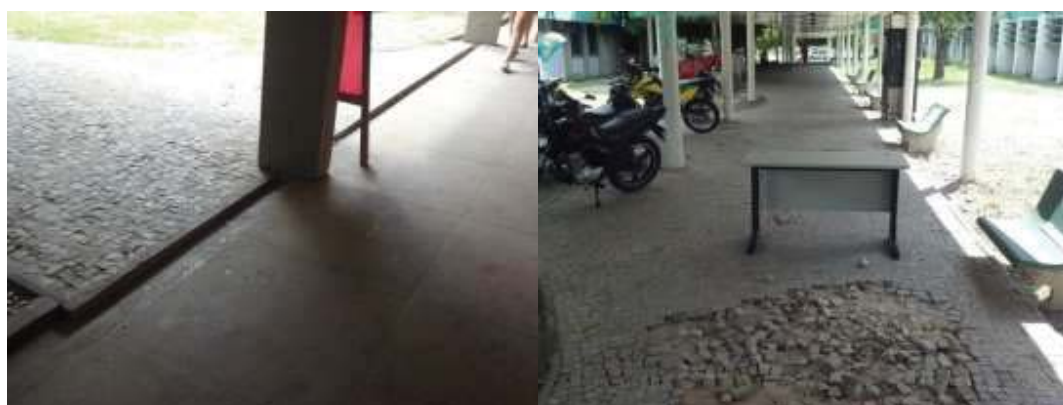
Fig. 6. Vãos e padronagens tridimensionais e com falta de manutenção.
