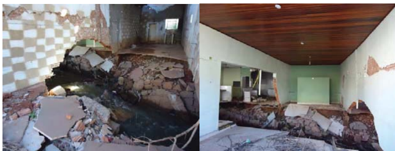
Fig. 5 Área comercial onde o piso cedeu no período de cheia de 2010 Fonte: SHS Consultoria e Projetos de Engenharia (2011)
