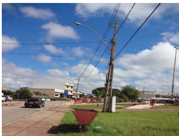
Fig. 4 Distribuição de energia – cabeamento aéreo Fonte: Assunção, 2014
