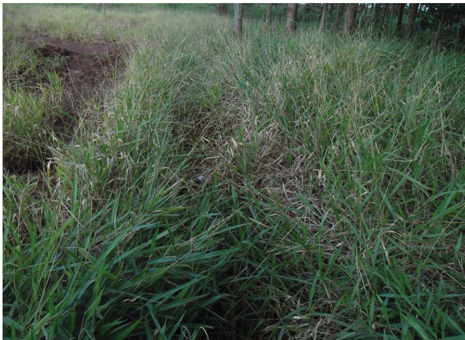
Fig. 6: Vegetação rasteira no sistema de drenagem de águas pluviais
