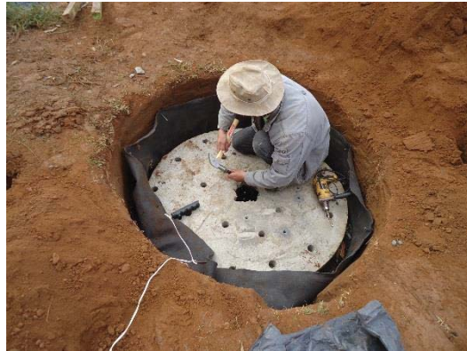
Figura 9- Tampa perfurada poço 2
