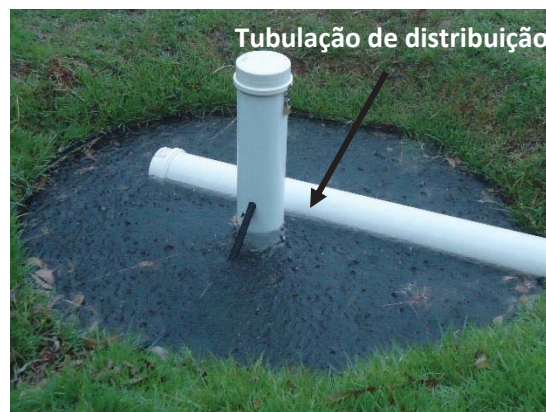
Figura 11- Poço 2 em funcionamento
