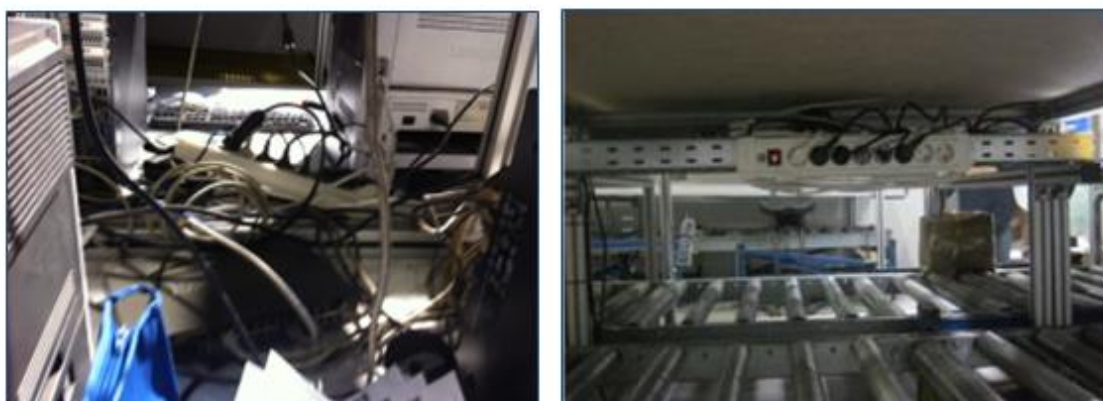
Figura 132 - Situação antes e após a arrumação e organização dos fios elétricos
