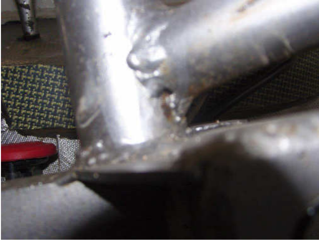
Figura 29 – Conjunto de imagens dos defeitos mais comuns encontrados nas ligações permanentes
