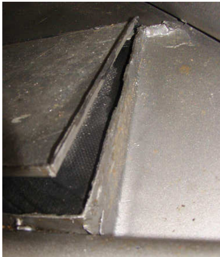
Figura 28 – Tampa solta do depósito de combustível
