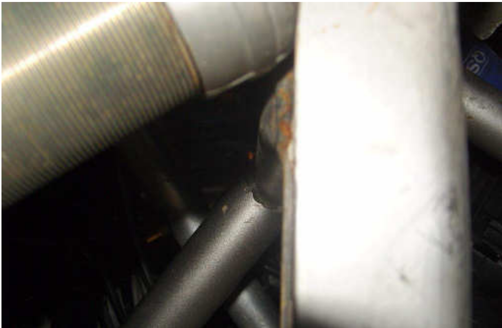
Figura 30 – Alguns exemplos do desalinhamento de barras estruturais
