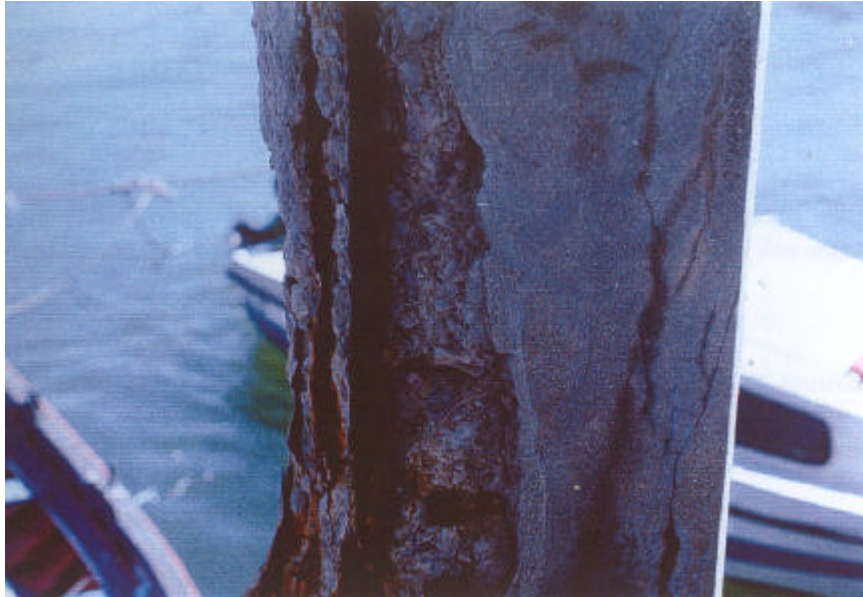
Figura 3.12 - Corrosão de um pilar numa cais [3.89]
