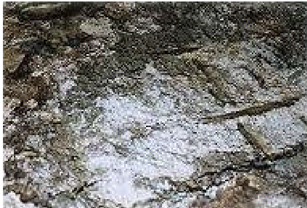
Figura 3.9 - Ataque de sulfatos numa laje.
