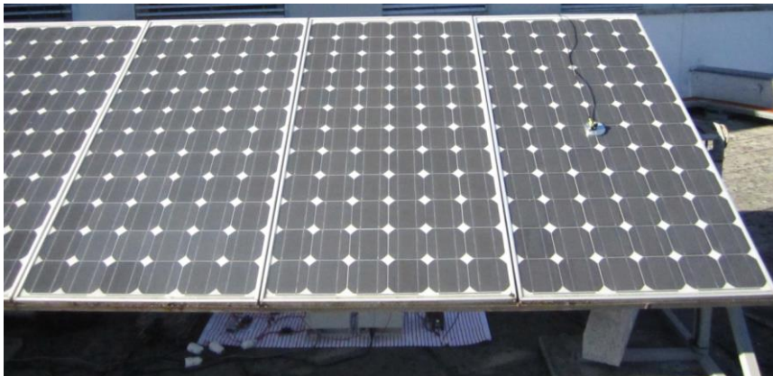
Figura 5.21 – Painéis solares BP2150S usados nos ensaios em ambiente real.
