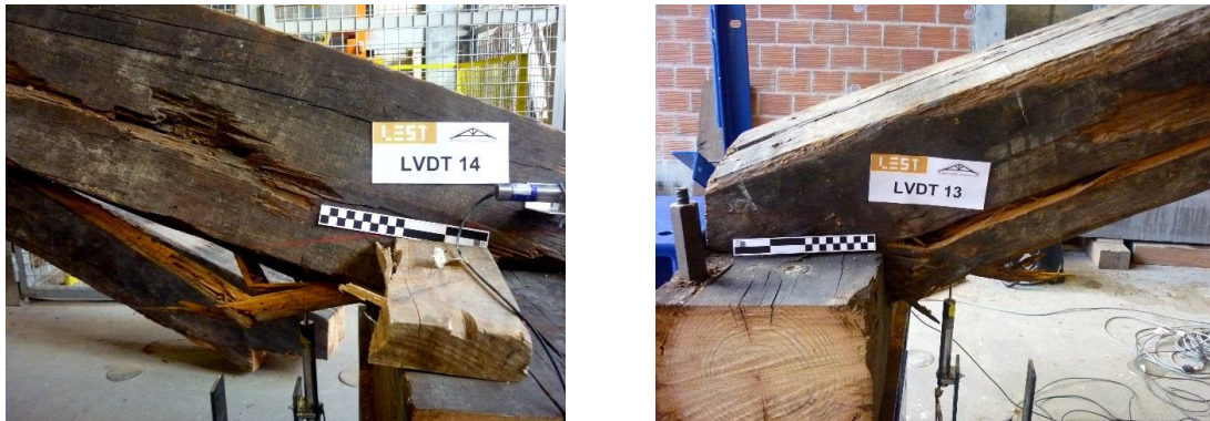
Figura 5.16 – Rotura local do apoio simples a Sul da asna
