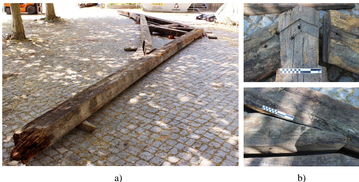
Figura 5.2 – Pré-montagem Asna 1: a) Asna completa; b) Exemplos de ligações em bom estado de conservação
