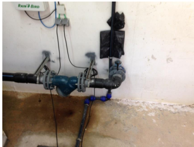
Figura 30 - Dispositivo de filtração instalado entre a bacia de retenção e as eletrobombas
