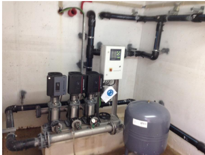
Figura 33 - Eletrobombas que constituem o sistema
