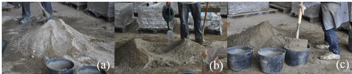
Figura 75: Preparação da mistura: a) fase seca (solo + cimento + caulino); b) adição de água; e c) colocação da mistura em baldes para prensar.
