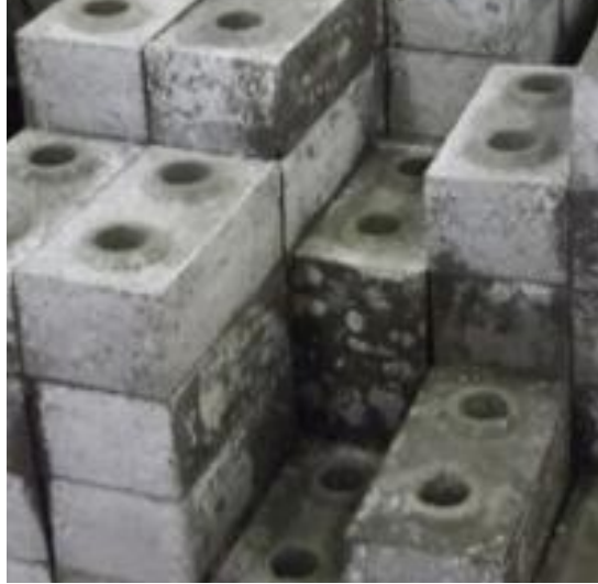
Figura 3. 10 : Eflorescências nos BTC
