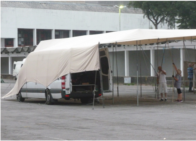
Fig. 34. Montagem de uma estrutura metálica. Estrutura dependente da máquina. Foto de autor
