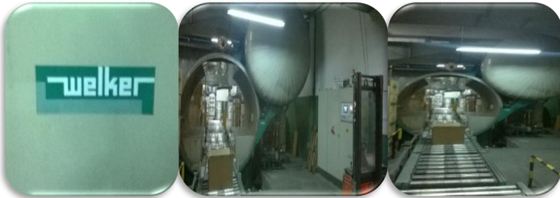
Figura 13 - Máquina de vaporizar WELKER - HUMIVAC®- Somelos MIX, S.A..
