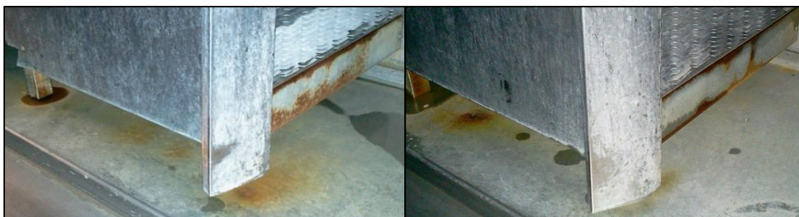
Figura 13. Ferrugem presente nos túneis.
