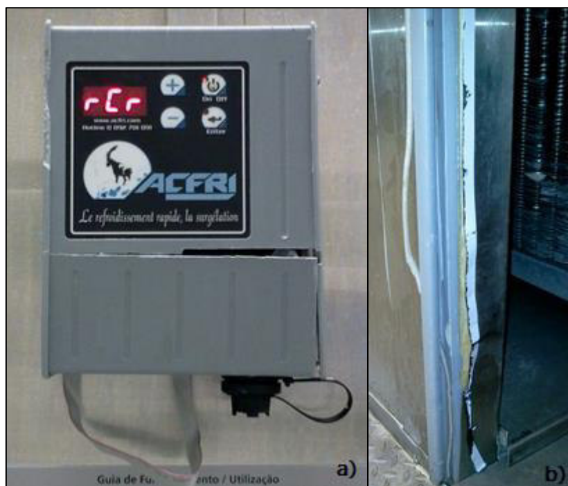
Figura 18. a) Caixa de programação dos túneis degradada; b) cabos soltos junto à porta do túnel.
