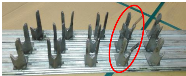
Figura 60 - Peças formato Kisters danificadas
