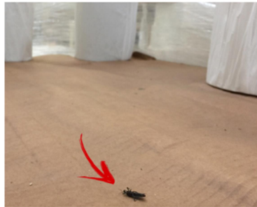
Figura 41- Resíduos causados pela falta de limpeza
