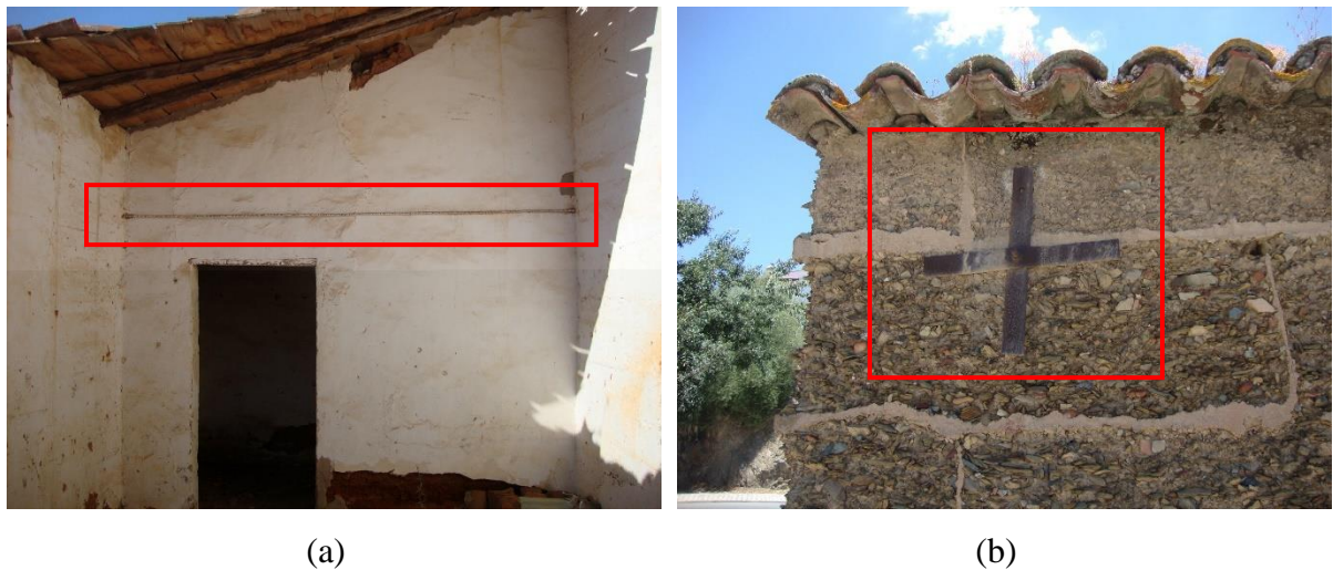
Figura 2.10: Reforço com tirantes (Martínez, 2015): (a) pormenor do tirante; (b) pormenor da ancoragem.
