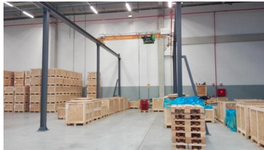
Figura 54- Nova ponte rolante para abertura de caixas instalada no novo armazém.
