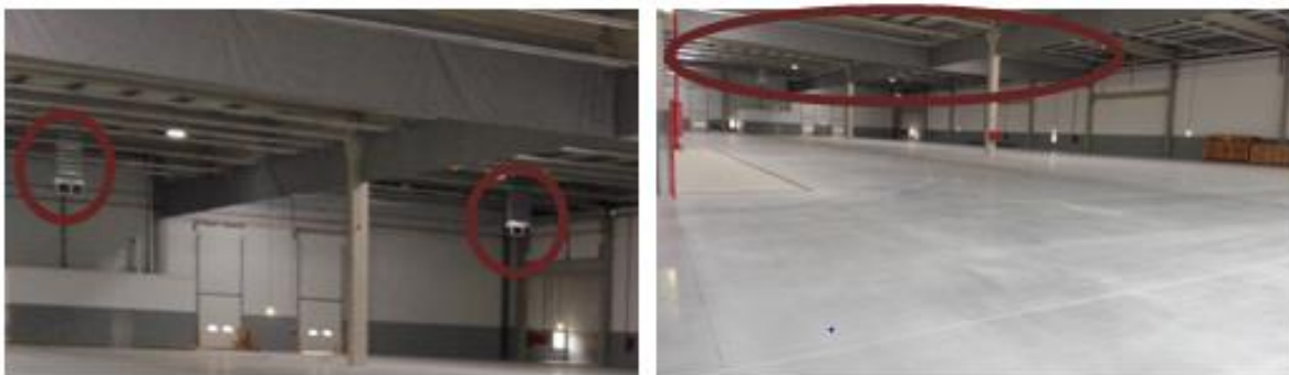
Figura 27- Barreiras arquitetónicas à instalação das racks de armazenagem (à direita: torres de ventilação; à esquerda: cortinas pára-fogo)
