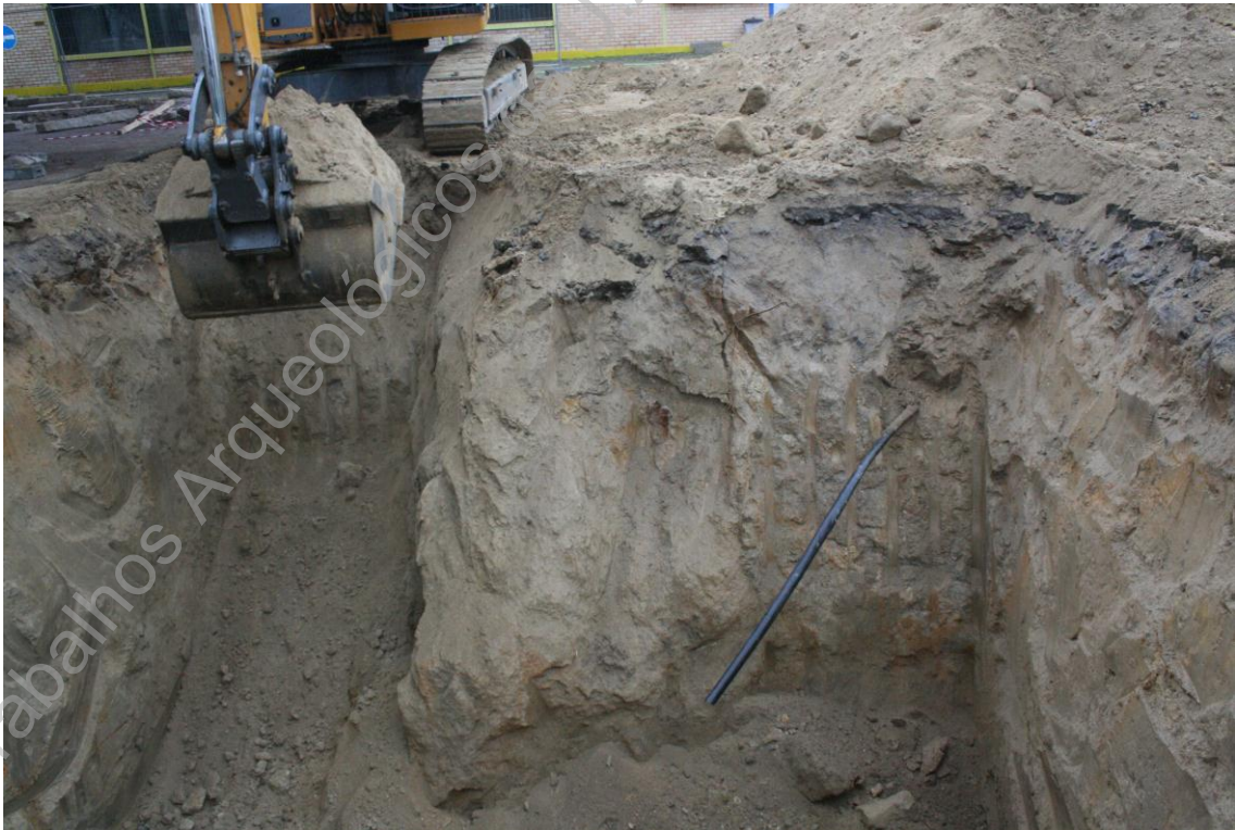
Foto 34 (BRA15ACP_IMG_6533) - Acompanhamento do desaterro mecânico para a colocação dos tanques de combustível
