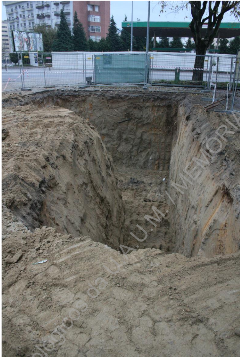
Foto 35 (BRA15ACP_IMG_6647) - Acompanhamento do desaterro mecânico para a colocação dos tanques de combustível
