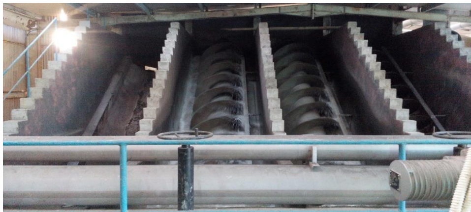
Figura 19 - Parafuso de Arquimedes da ETAR do sistema Cidade.
