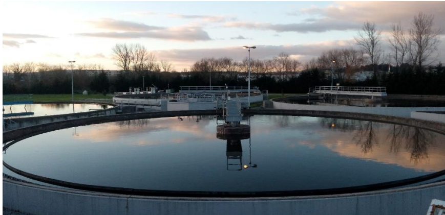
Figura 29 - Decantadores secundários da ETAR do sistema Cidade.
