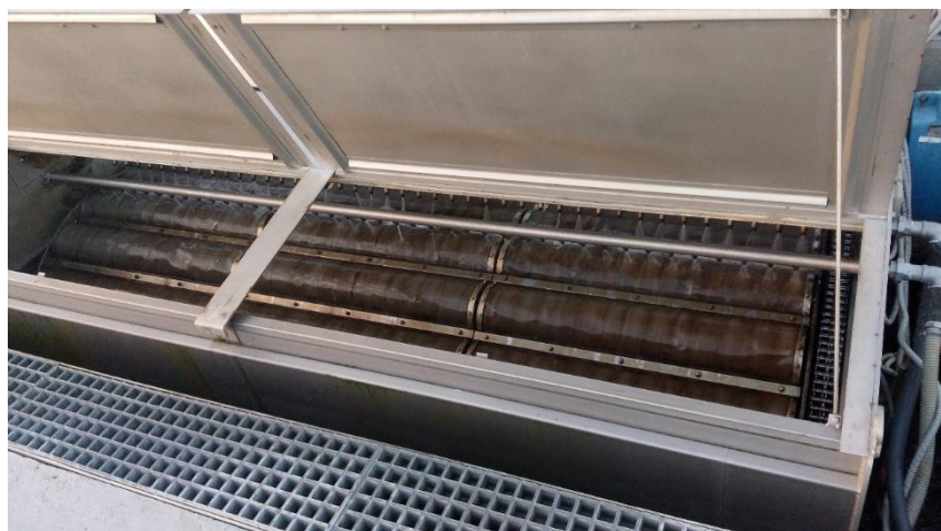
Figura 31 - Microfiltração da ETAR do sistema Cidade.
