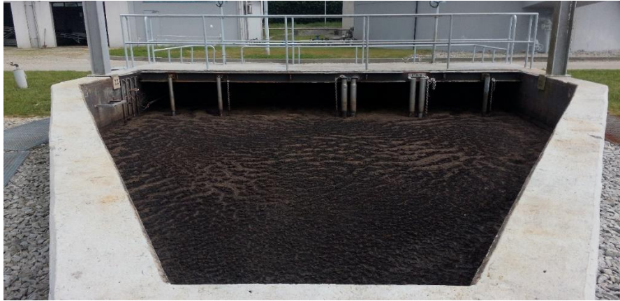
Figura 30 - EE de recirculação externa de lamas e purga de lamas em excesso
