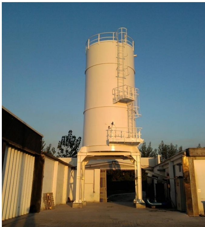
Figura 37 - Silo de armazenamento de lamas da ETAR do sistema Cidade.
