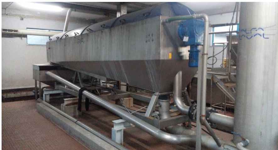
Figura 35 - Espessamento de lamas por meios mecânicos, da ETAR do sistema Cidade.
