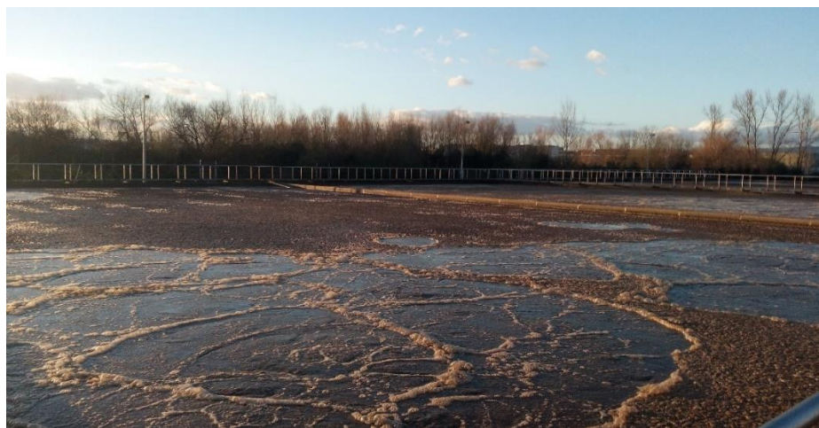
Figura 26 - Tanques de arejamento da ETAR do sistema Cidade.
