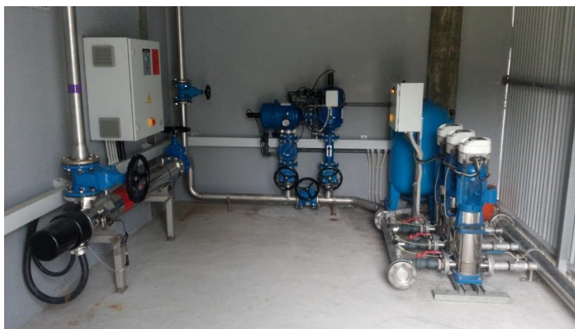
Figura 33 - Equipamento responsável pela reutilização de efluente final tratado, da ETAR do sistema Cidade.
