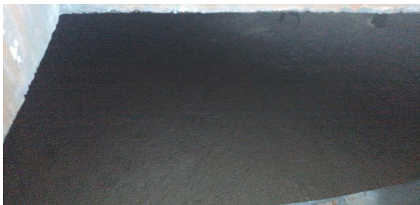
Figura 34 - Interior dos homogeneizadores, da ETAR do sistema Cidade.
