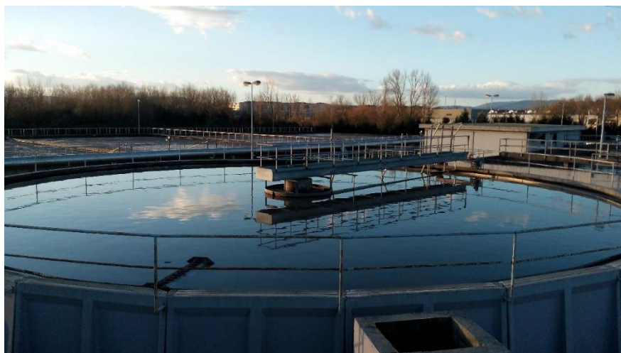
Figura 25 - Decantadores primários presente da ETAR do sistema Cidade.
