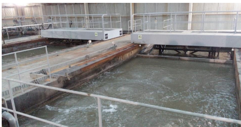
Figura 22 - Desarenadores/desengorduradores presente da ETAR do sistema Cidade.
