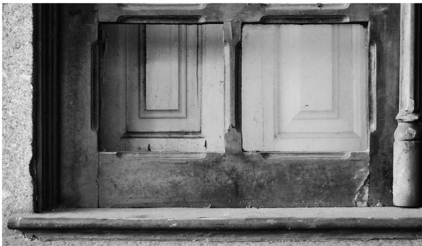
Fotografia do autor. Janela do Edifício do Castelo em estado de degração avançado.
