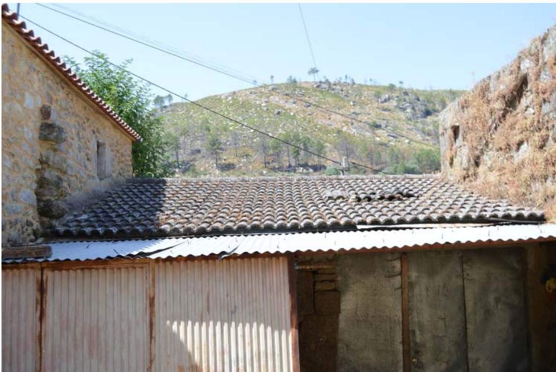
Foto 18: Pormenor do arranque de parede no primeiro piso no alçado norte do moinho a Sul do Aljube (Foto 817_DSC_0177)
