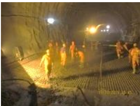
Fig.344-Trabalhadores muito próximos entre eles [31]
