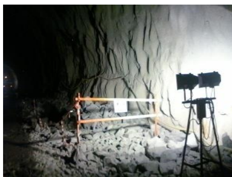
Fig.114-Projetor de iluminação provisório [31]
