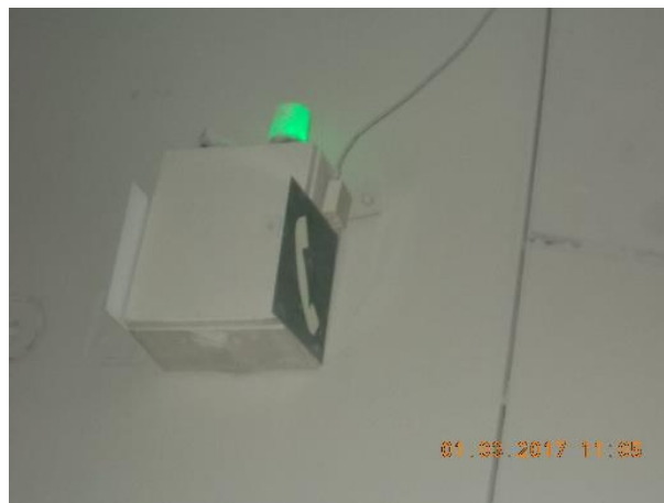
Fig.60-Telefone no interior de túnel [58]
