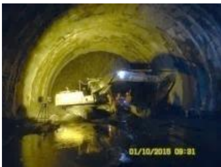
Fig.165-Ausência de separação face/zona trabalhos [31]
