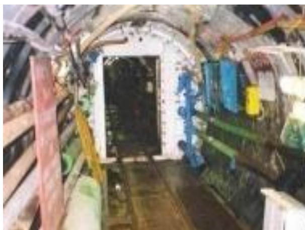
Fig.42-Câmara de compressão [127]
