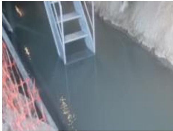
Fig.82-Acesso a estrutura de montagem de impermeabilização bloqueado [31]
