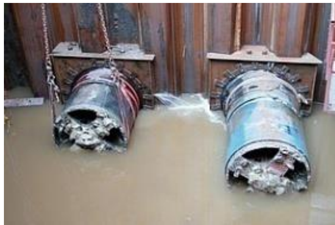
Fig.83-Afluência de água em emboquilhamentos [319]
