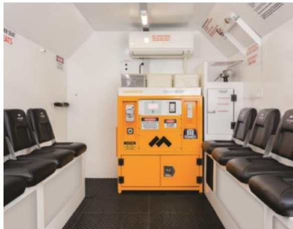
Fig.71-Interior de câmara de refúgio [296]
