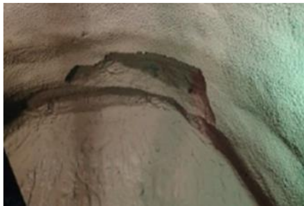
Fig.38-Troço de abóbada com queda de betão projetado [162]
