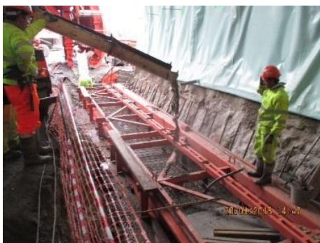
Fig.206-Deposição de resíduos betão em cofragem [31]
