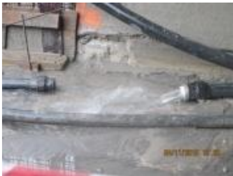
Fig.200-Tubagem em pressão danificada [31]
