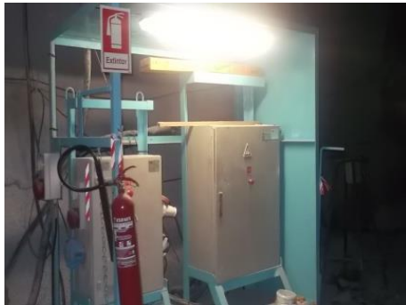
Fig.159-Quadro elétrico junto a face de escavação [31]
