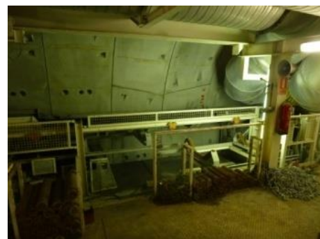
Fig.121-Mangas rígidas de ventilação [58]
