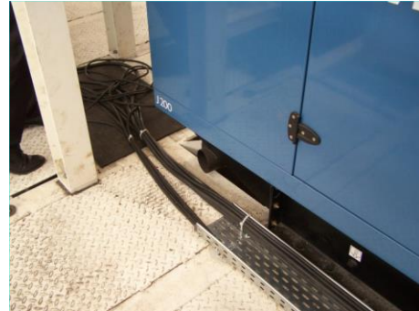
Fig.111- Instalações elétricas da tuneladora [127]
