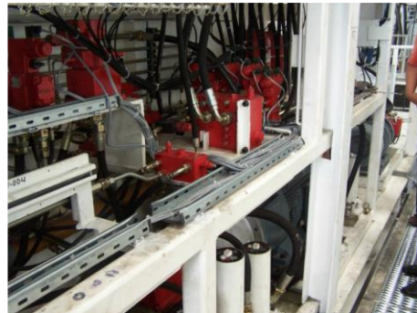
Fig.160-Instalações elétricas em tuneladora [127]
