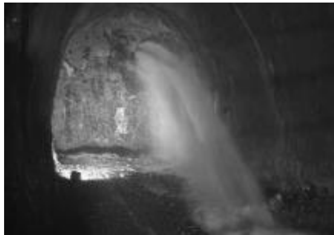
Fig.81-Afluência de água a frente de escavação [310]
