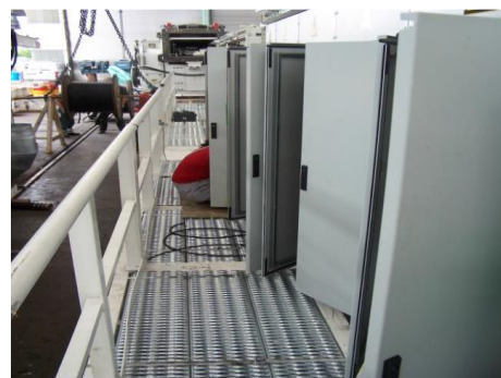
Fig.142-Quadros elétricos em tuneladora [127]
