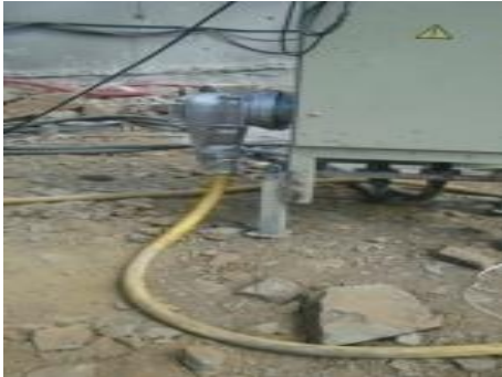
Fig.110-Cabo elétrico sujeito a dano [31]
