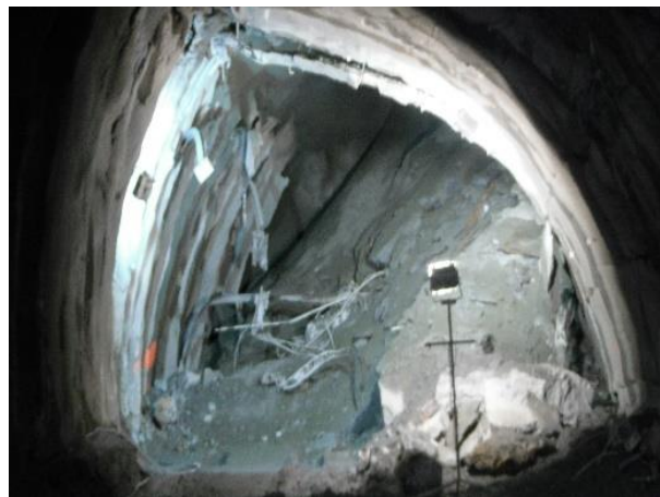
Fig.80-Derrocada junto a face de escavação [277]
