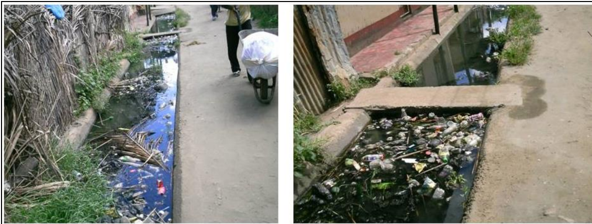
Figura 2 - Canal de drenagem assoreado devido ao depósito de resíduos.
