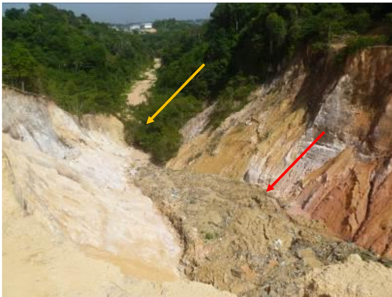
Figura 4 - Interior de uma voçoroca no Bairro Distrito Industrial II (Zona leste de Manaus), com intervenção humana e deposição tecnogênica. Seta Vermelha indica a localização da Deposição Tecnogênica; Seta amarela indica o canal assoreado. Fonte: Armando Brito da Frota Filho, 2015.
