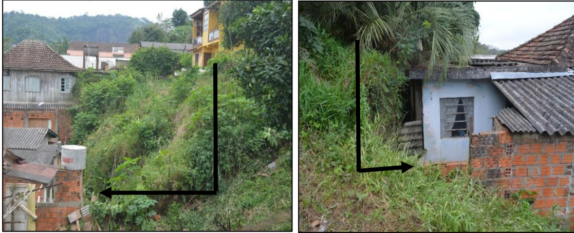
Figura 5- Distância do corte do talude em relação as moradias
